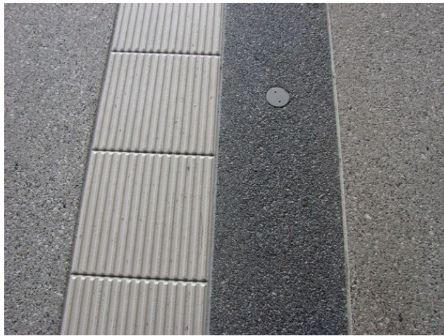
Bild 11: Leit- und Begleitstreifen auf den S-Bahnsteigen Julius-Leber-Brücke. Entgegen den Forderungen der Norm DIN 32984 ist der dunkle Begleitstreifen nicht glatt und hat zum angrenzenden übrigen Bodenbelag keinerlei tastbaren Kontrast
