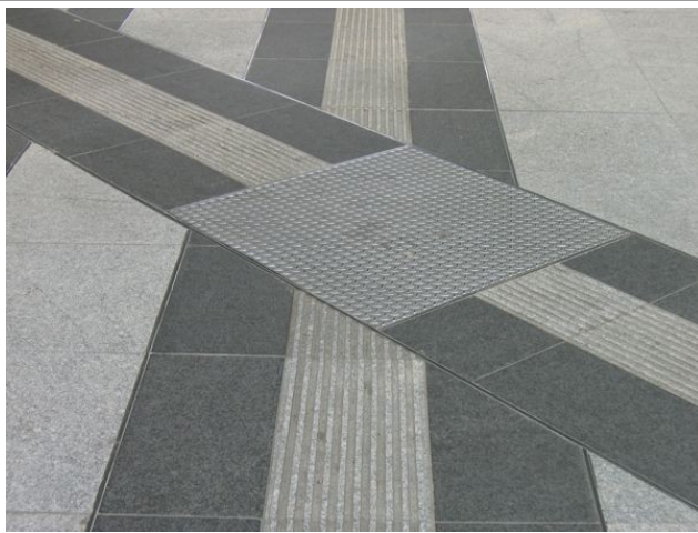
Bild 9: Und so sieht das bekannte Berliner Aufmerksamkeitsfeld als hohl verlegte, Oberflächen-strukturierte Blechplatte aus. Hier in einem sehr komplexen, schiefwinkligen Leitsystem auf dem Bahnhof Südkreuz, Ringbahnsteig
