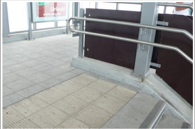
Bild 18: Unfreiwillig zeigt dieses Bild des S-Bahnhofs Julius-Leber-Brücke, wie die Auffindbarkeit und Leitfunktion des Doppelhandlaufs durch Hintergrundkontrast verbessert werden kann: hier ist als Bauprovisorium eine dunkle Platte eingebaut. Sie wird durch kontrastloses Glas ersetzt werden!
