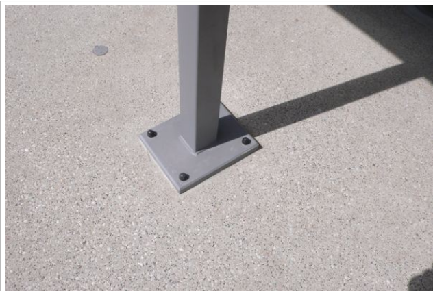
Bild 21: Offen auf dem Bahnsteigbelag liegender Stützenfuß am überdachten Wartehäuschen
